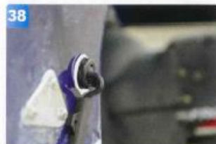
38 Kabeln läggs i kabelhållaren för att den ska få rätt böjvinkel från genomföringen.
